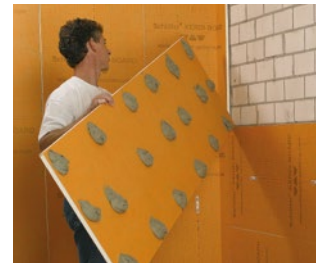
Na ścianach stanu surowego i podłogach mieszanych
