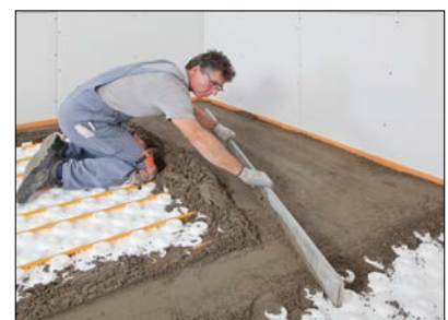
6 Druckprobe – Vor dem Einbringen des Estrichs ist eine Druckprüfung durchzuführen (siehe Druckprobenprotokoll, technisches Handbuch). Der Einbau des Estrichmörtels erfolgt ohne Bewehrung und ohne Bewegungsfugen (Estrichgüte CT-C25-F4, max. F5). Ausnahme: im Türbereich, mit Kellenschnitt oder Dehnfugenprofil Schlüter-DILEX-DFP sowie bei Bauwerkstrennfugen.
