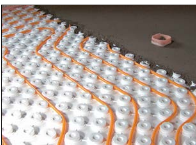
7 Abziehen der Estrichfläche mit einer Mindestüberdeckung von 8 mm über den Noppen. Höhenausgleich bei bereichsweisen Unebenheiten max. 25 mm Estrichüberdeckung.
